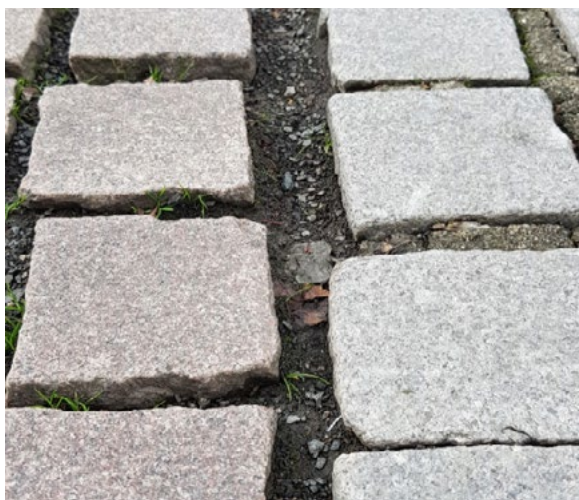
Bild 6. Stensättning där fogsanden har försvunnit och mekanisk låsning delvis försvunnit.
