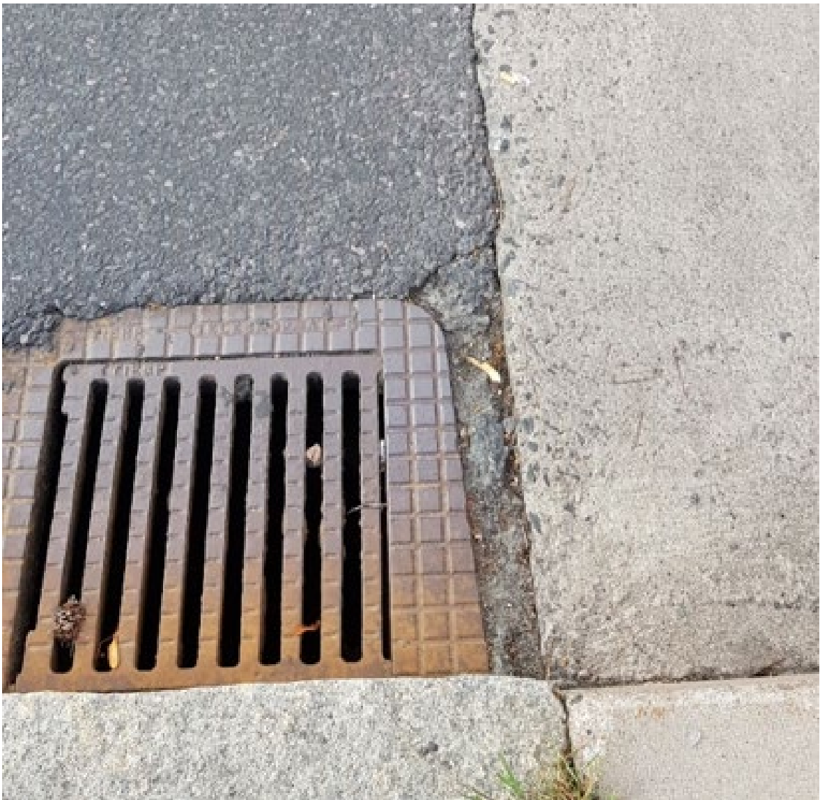
Bild 10. Skada mellan asfalt och cementbetong.
