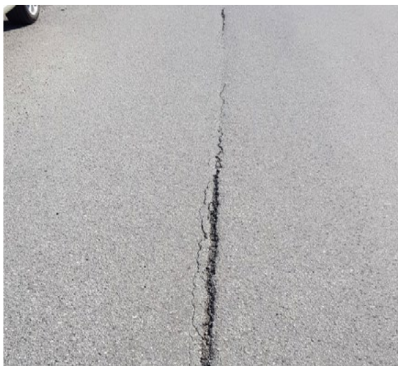
Bild 4. Sprickbildning i beläggningsskarv.
