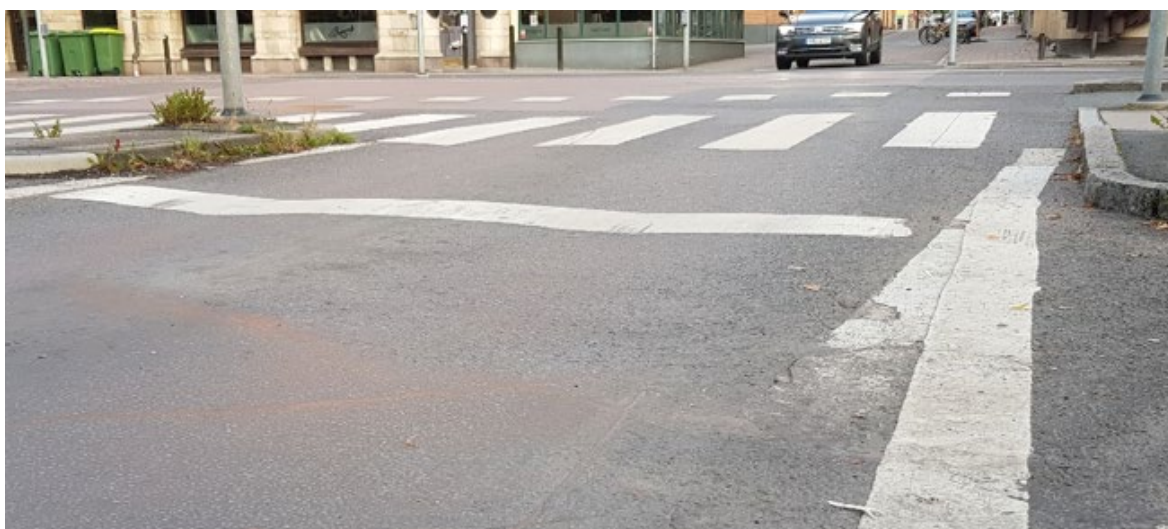
Bild 8. Plastisk deformation i asfalt vid ljusreglerad korsning.
